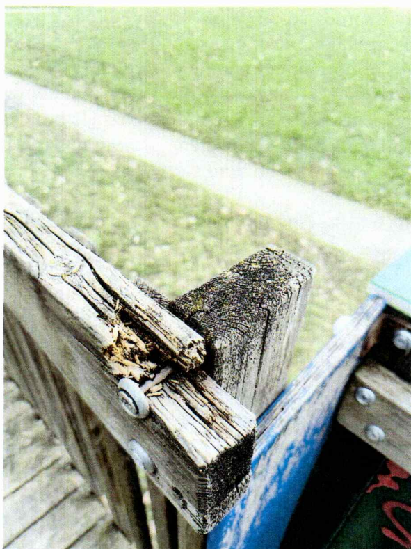
Foto 08 – zaštitna ograda na višenamjenskoj spravi se odvaja od stupova
