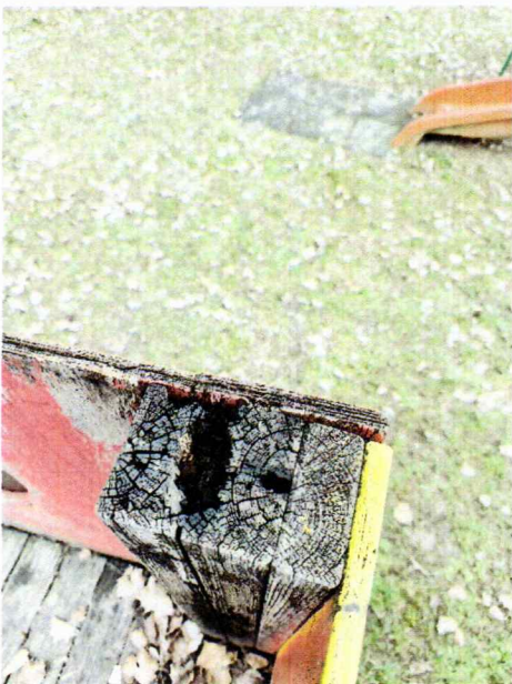
Foto 06 – nosivi stupovi višenamjenske sprave su dotrajali i nedostaju zaštitne kape na vrhovima stupova
