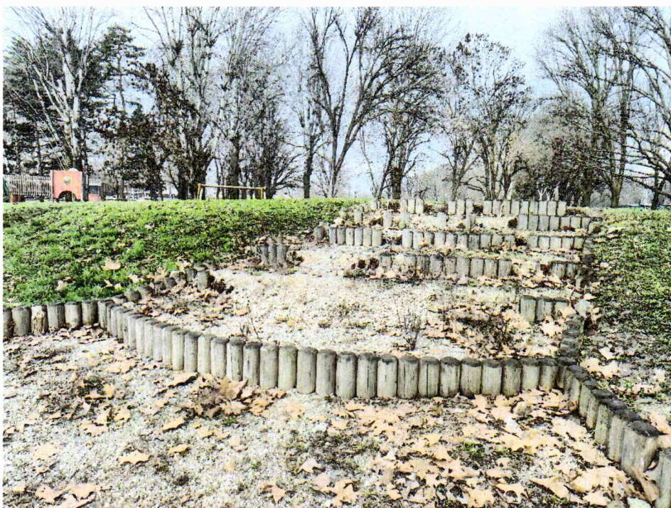
Foto 07 – zaštitni stupići su dotrajali i strunuli
