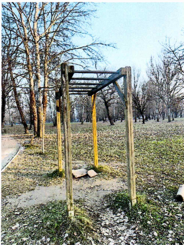
Foto 16 – nosivi stupovi su truli, a nakon kiše se stvara blato ispod sprave
